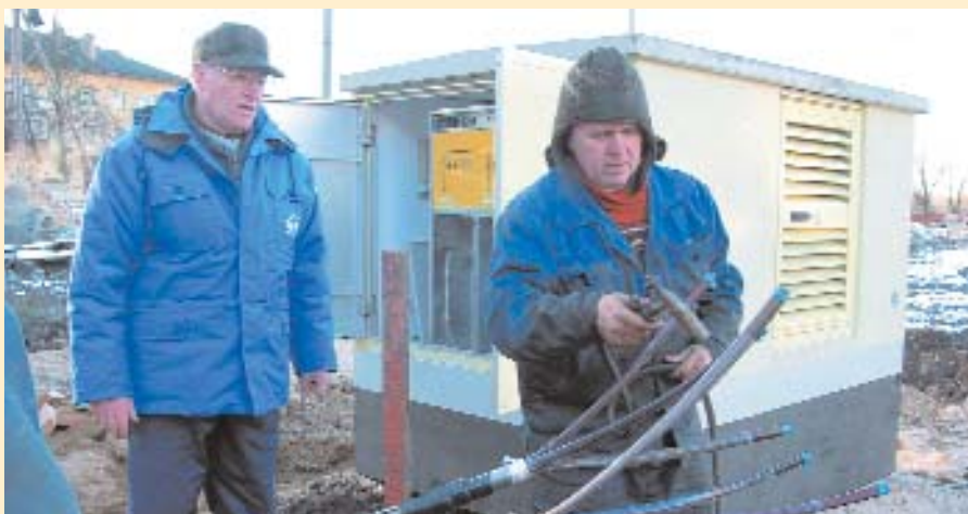
ЯНИС ВАЛДИС (СЛЕВА): Мы не только помогли установить новую подстанцию, но и подробно проконсультировали псковских энергетиков по вопросам эксплуатации.
